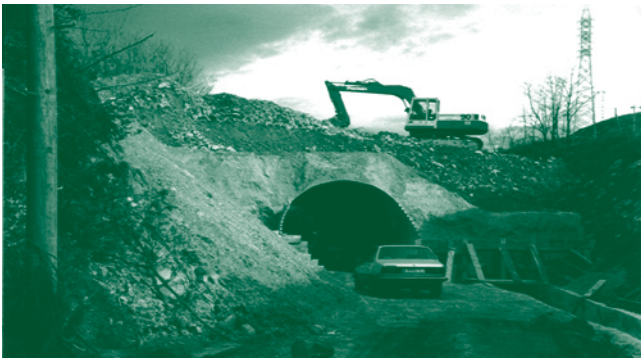
Fotografía 3 y 4. Momentos de la construcción del puente y del paso elevado, como labores del nuevo proyecto.
