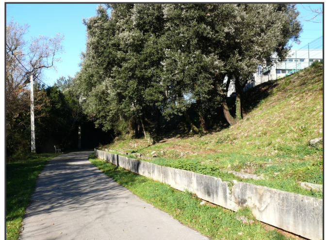
Fotografía 9. Canalón de hormigón prefabricado.
