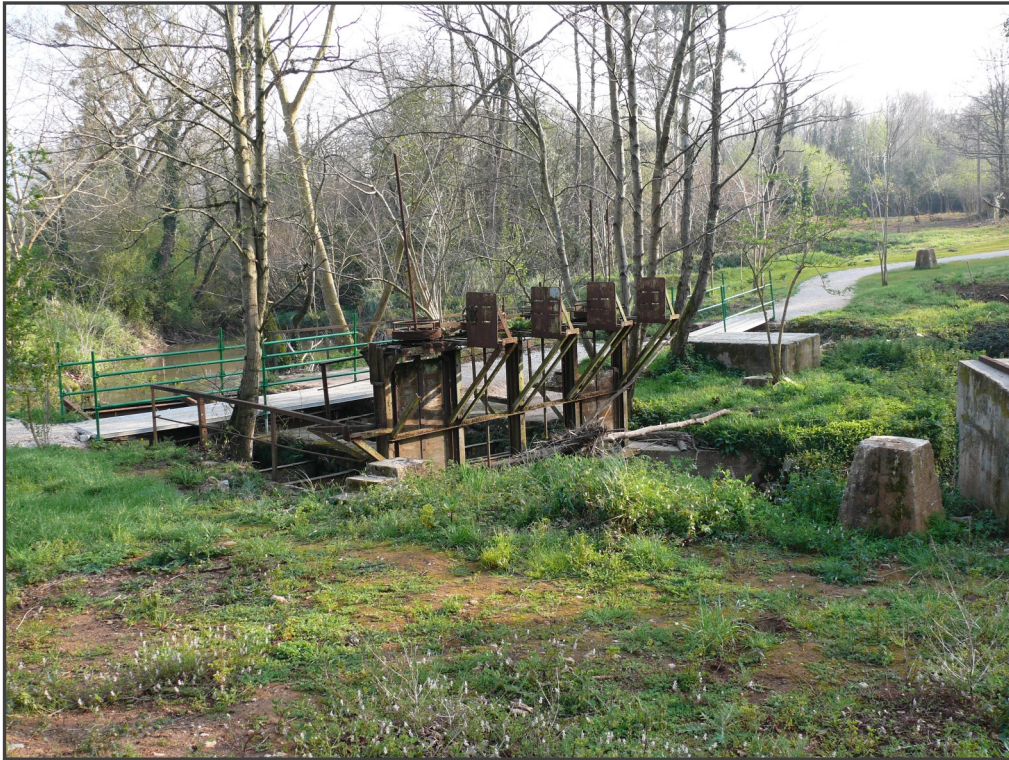
Fotografía 16. Compuertas en el Canal de la Mina para regular el agua.
