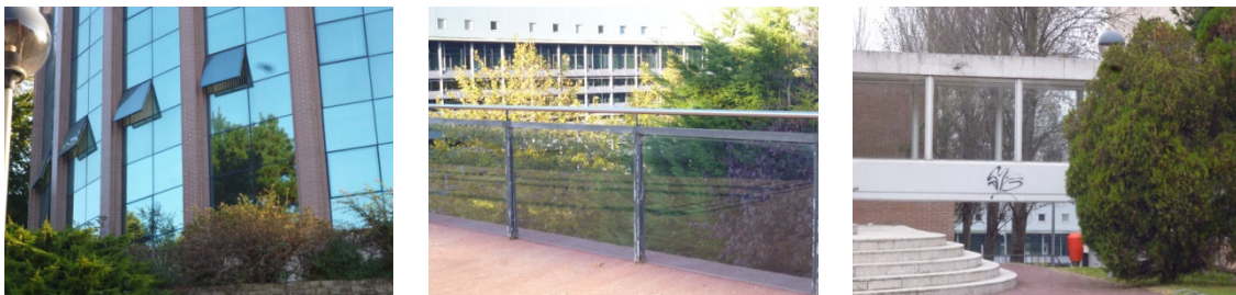
Figura 24: Estos son algunos de los múltiples ejemplos de zonas acristaladas que pueden generar problemas de colisión.
